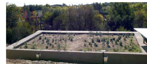
Cubierta ecológica en módulo almacén.
