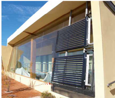
Panel captador de energía solar compuesto por tubos de vacío y dispuesto en la fachada del edificio del CREAS. Está formado por dos módulos de 15 tubos cada uno.
