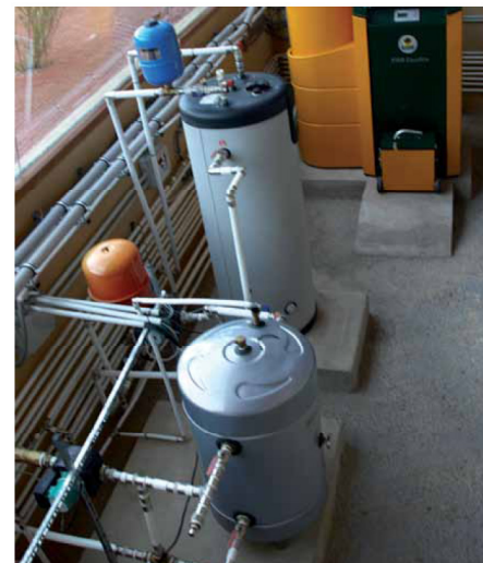
Caldera con el dosificador y los elementos de control de la instalación.
