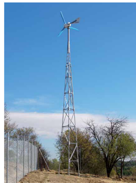
Instalación dispuesta en el CREAS, constituido por un aerogenerador de 1.500W.
